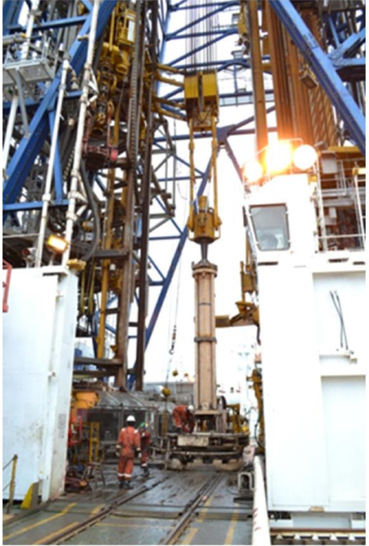
වීදුම් තට්ටුව (Drill Floor)
